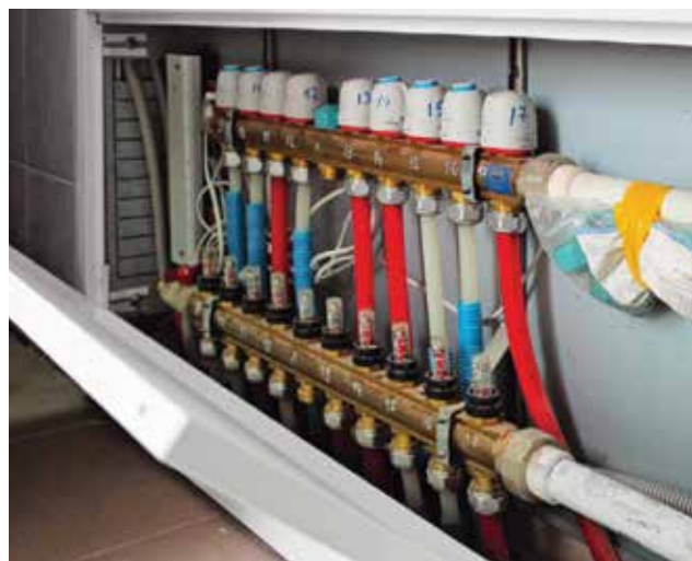
Геотермальная система отопления в детском саду с. Турунтаево
