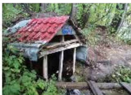
После работы регулярно канализация: вырезаны все лотки, сорваны таблички, разрушен мостик. Август 2015 г.
